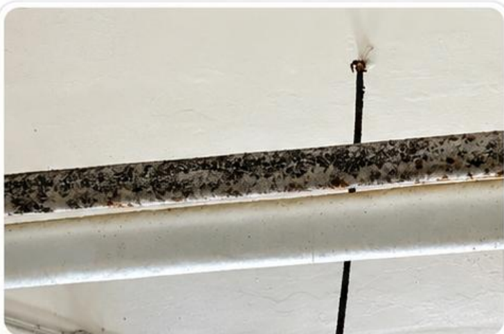
烹調區管線積塵、支撐架鏽蝕
