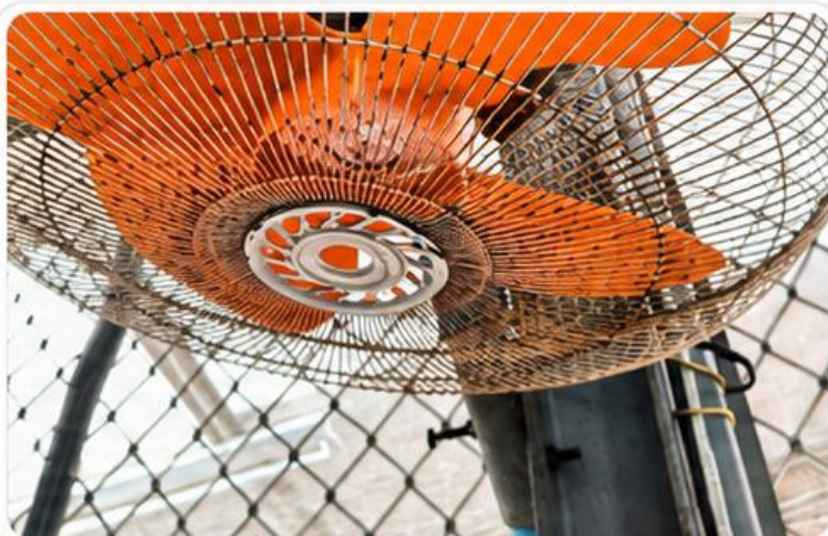
風扇鏽蝕、氣流帶動、可能產生鐵屑
